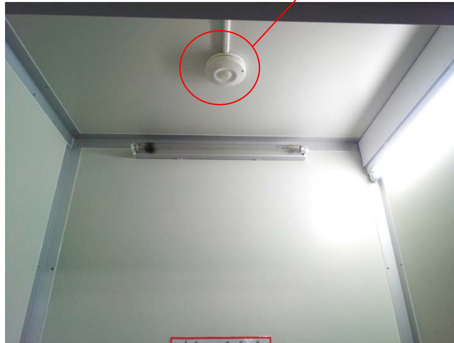
เซนเซอร์ตรวจจับการเคลื่อนไหว
